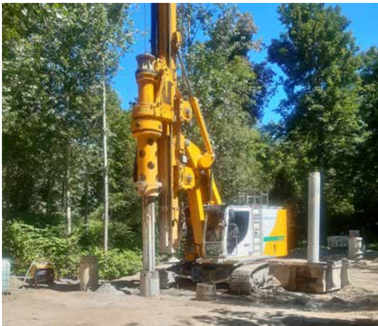
Foto: Für den Bau einer Brücke für den Hochwasserrückhalteraum werden Bohrpfähle gesetzt. Foto: RPF
