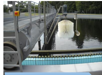
Rinnenreinigung der Räumerlaufbahnen
